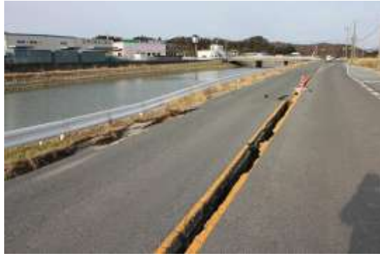
沿岸部の道路は陥没したまま
